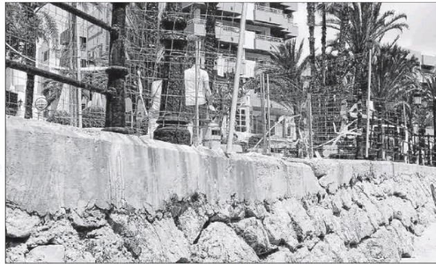
El tramo del paseo cuyas obras se iniciarán el próximo lunes. Foto: AYTO DE SANTA EULÀRIA
