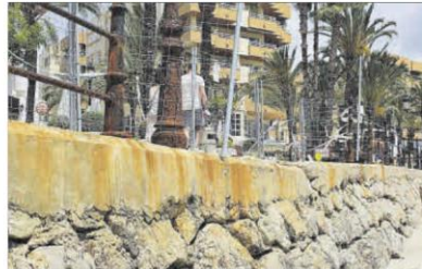
Parte del muro que se debe reparar.
